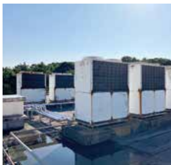
給食棟の室外機
