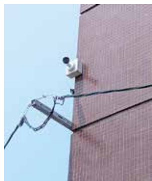
町民体育館に設置された防犯カメラ
