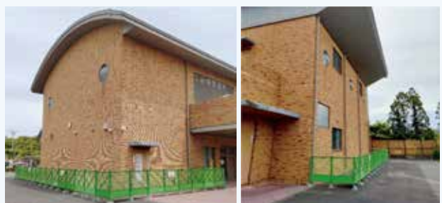
落下する恐れがある、シーメイトの外壁
