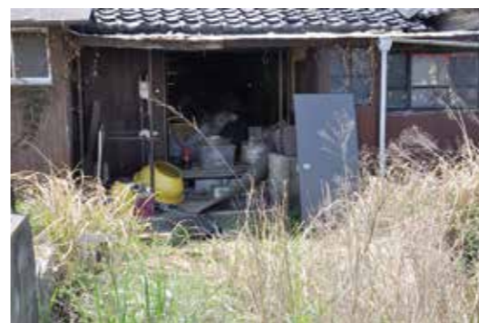
ごみが山積した空き家
