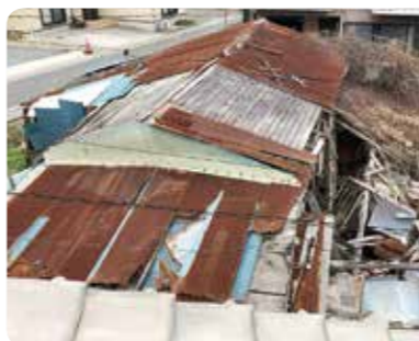
放置された空家
