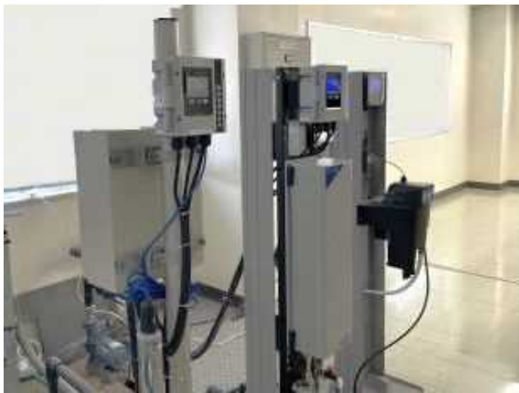
水質自動監視装置
