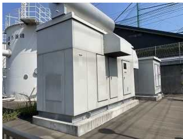
土生山浄水場内自家発電設備
