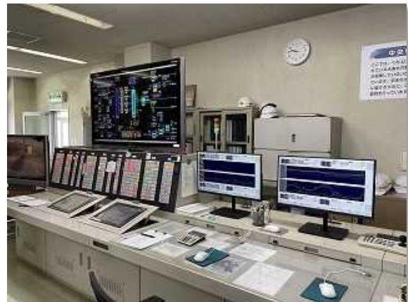
土生山浄水場（監視制御室）
