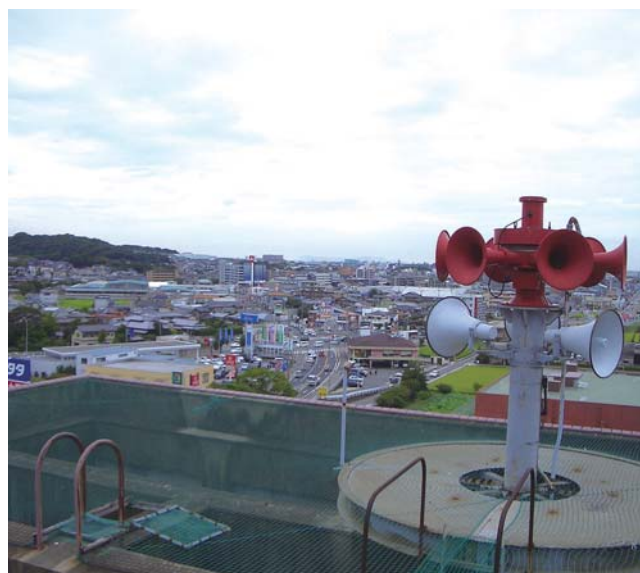
▲庁舎屋上の防災無線
