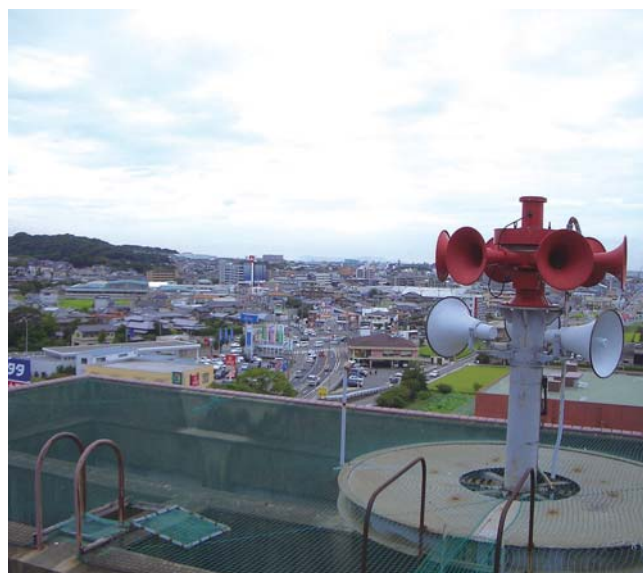
▲庁舎屋上の防災無線
