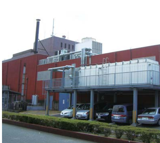
▲庁舎の氷蓄熱設備
