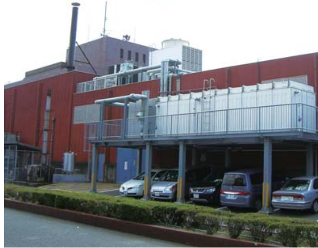
▲庁舎の氷蓄熱設備
