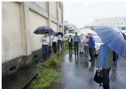
老朽が著しい東地区社会体育館
