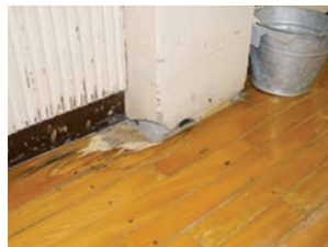
老朽化で破損した柱 (東地区社会体育館)
