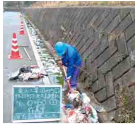
▲ごみでうまった排水路
