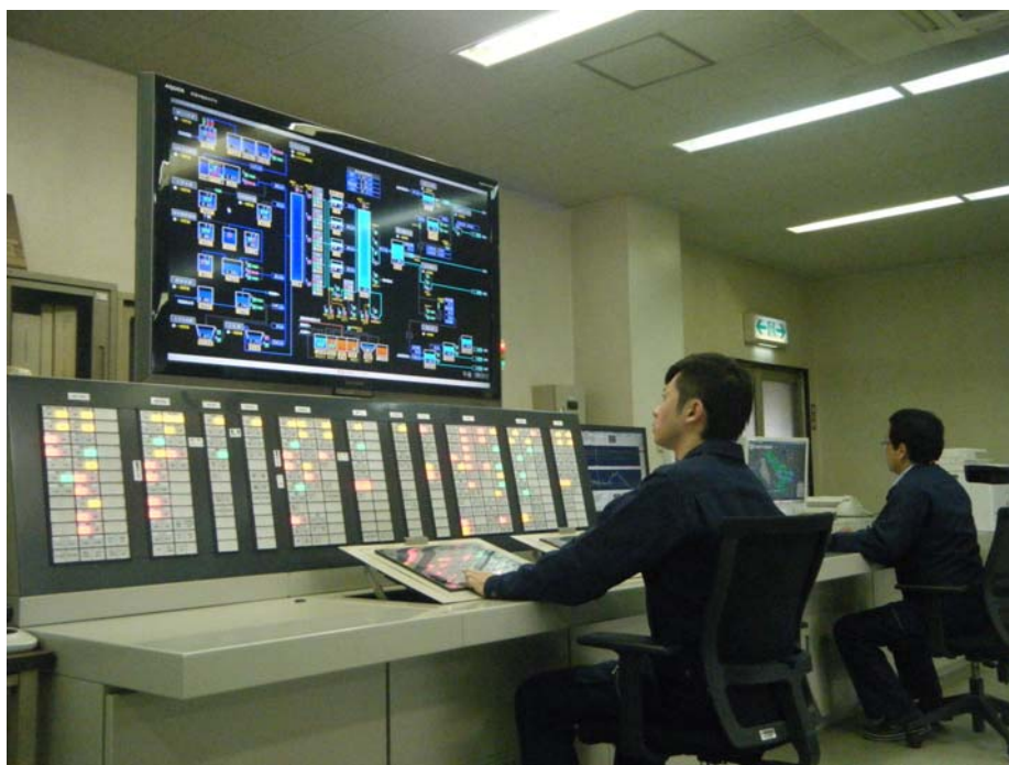
土生山浄水場(中央監視制御室)
