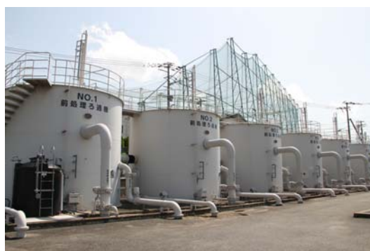
土生山浄水場(前処理ろ過・急速ろ過機)
